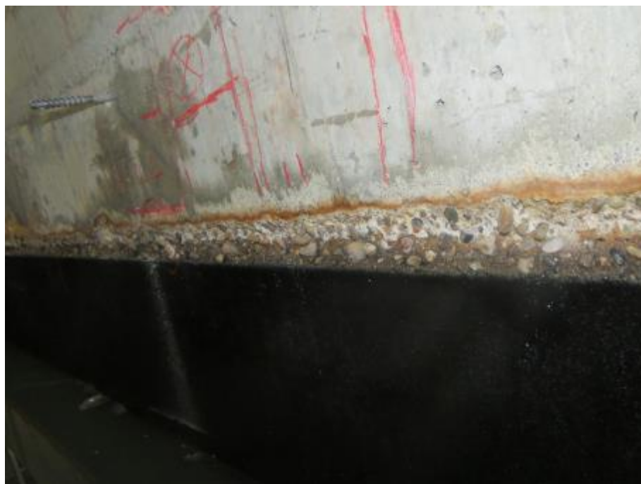
Fig. 2 : Aspect du béton en zone de marnage, à proximité du prélèvement 44574-2, bâtiment 22
