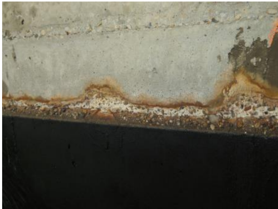
Fig. 4 : Aspect du béton en zone de marnage, à proximité du prélèvement 44574-5, bâtiment 21
