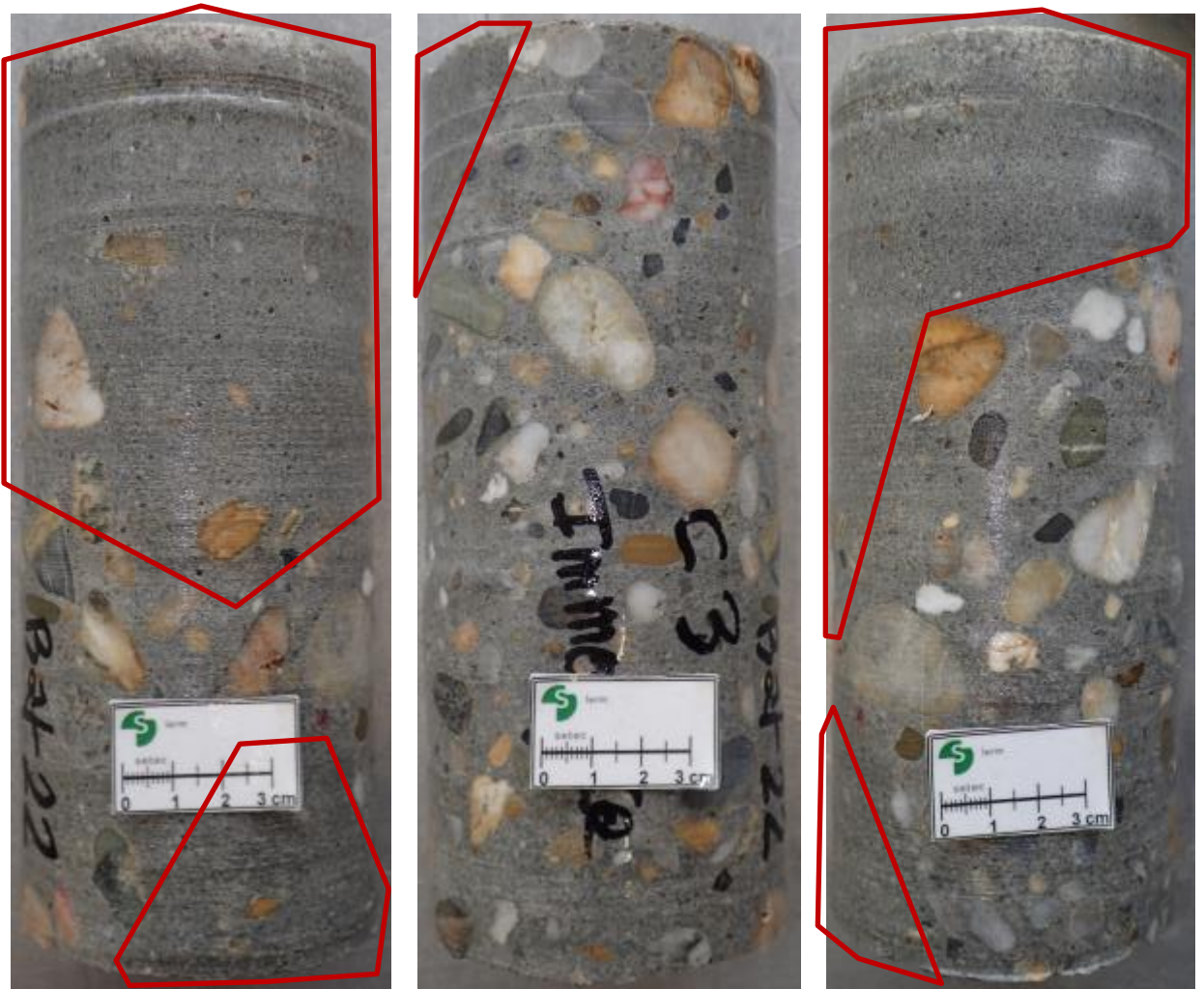
Fig. 63 : Prises de vues photographiques de l'échantillon 44574-3, prélevé en zone immergée du bâtiment 22 L'échantillon a été préalablement humidifié afin de mieux mettre en évidence les zones pauvres en granulats, entourées en rouge
