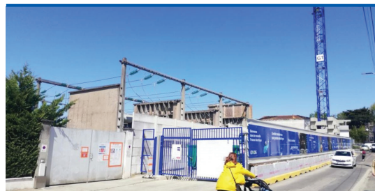
Vue du poste source en travaux depuis l'avenue de Lognac. @ Crédit photo : O.D
