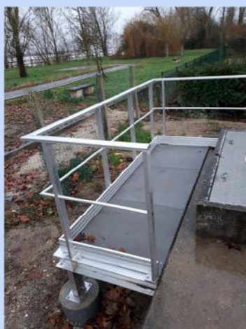
Renouvellement des passerelles de sécurité
