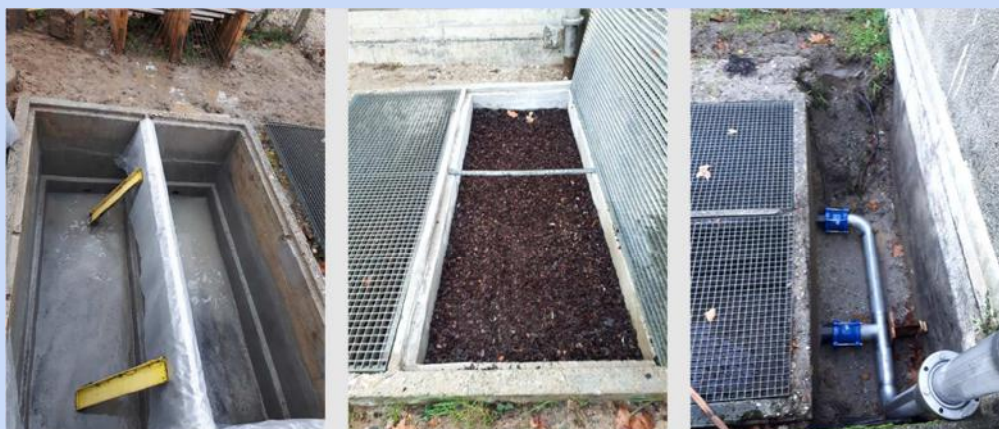
Filtre de désodorisation repris entièrement
