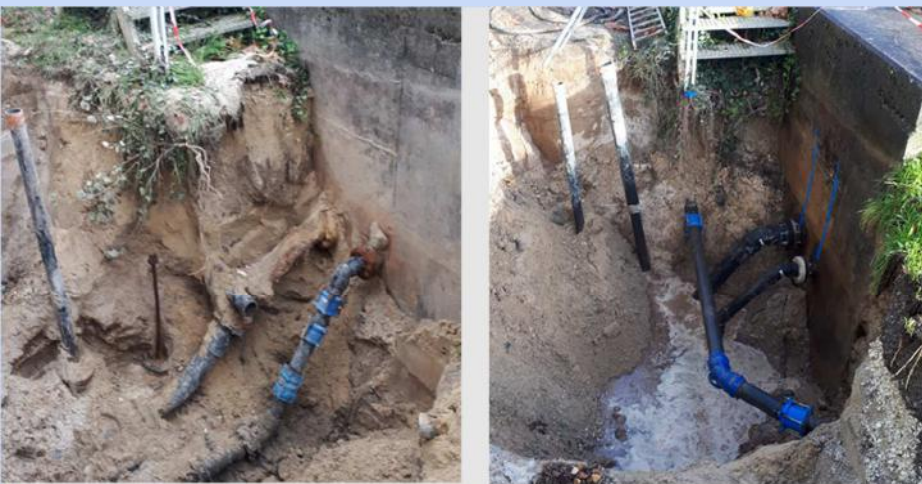
Reprises des canalisations sous vide
