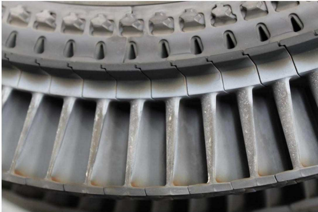
Photo 14 – État des aubes de turbine de l'étape 1
