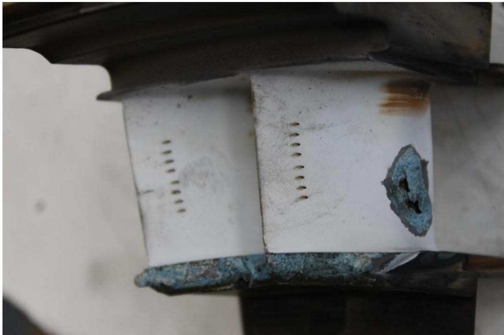
Photo 13 – Aube de turbine étage 1 érodée
