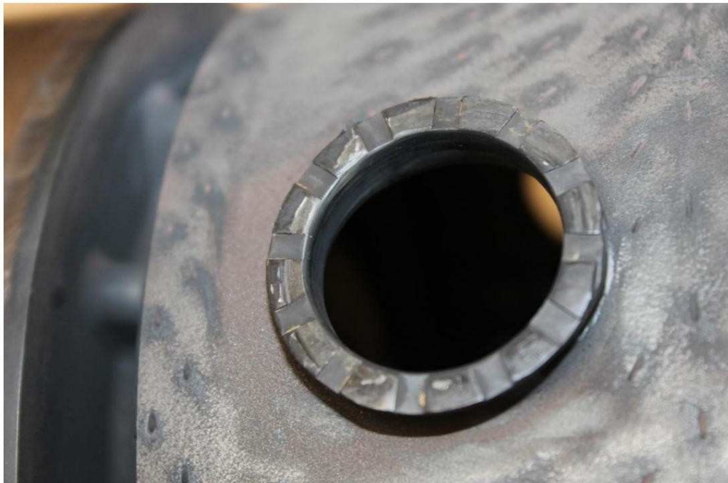
Photo 6 - État de la face de la virole de croisement de chemise
