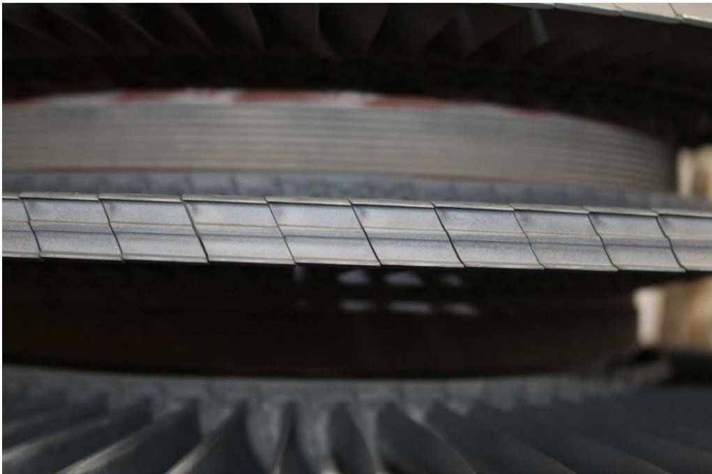
Photo 20 – État des aubes de turbine de l'étape 3
