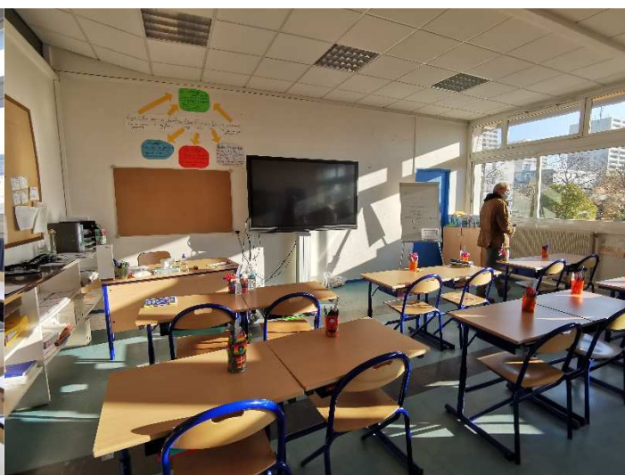
Classe avec dalles de sol amiantées
