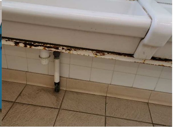
Traces de corrosion sous les auges des filles
