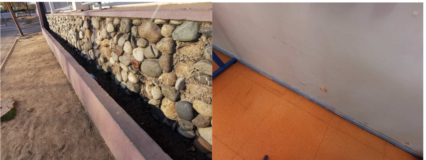
Traces d'humidité en parties basses des murs à l'arrière des jardinières devant les soubassements en gabions
