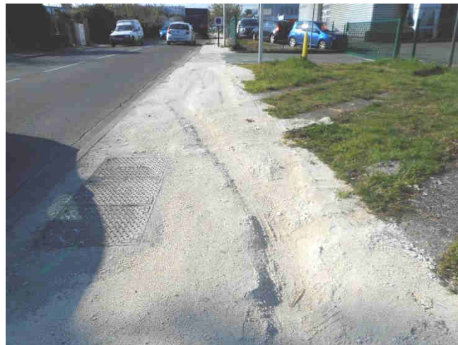
C10 Revêtement de trottoir inconfortable
