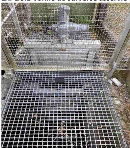
PHOTOGRAPHIE 6 - EXPL.8.1 Vanne de surverse asservie au niveau de la Jalle.
