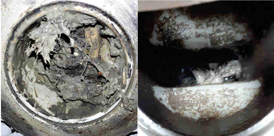
PHOTOGRAPHIE 21 - EXPL 8.1 VUE AMONT DE DÉBITMÈTRE ET PHOTOGRAPHIE 22 - EXPL 8.1 VU AVAL
