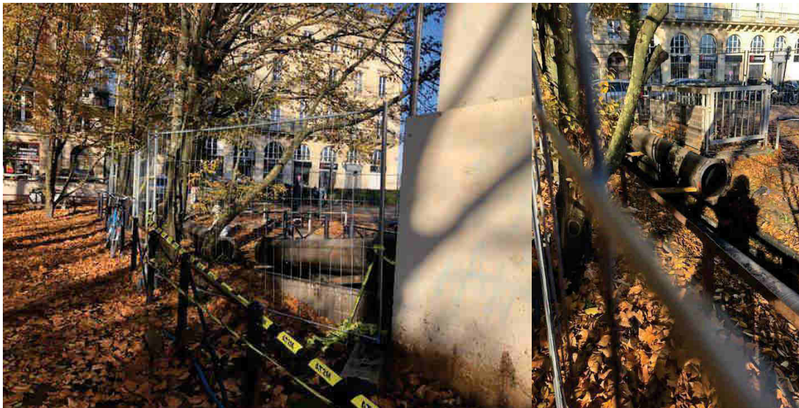
PHOTOGRAPHIE 23 ET 24 - EXPL 8.1 CANALISATION DE REFOULEMENT DES GAZ DES GROUPE ELECTROGENE
