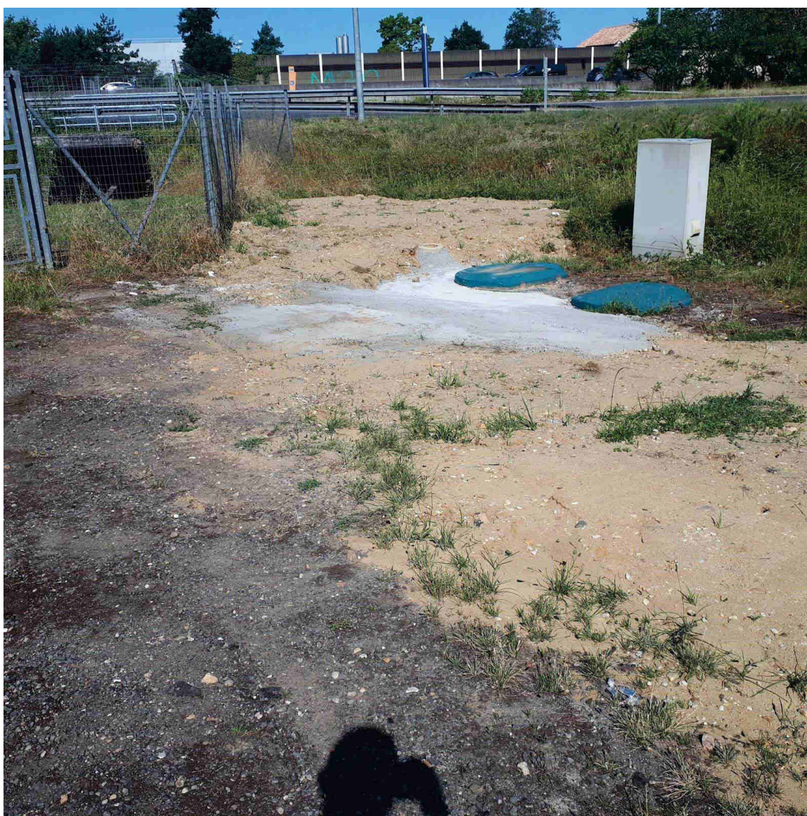
PHOTOGRAPHIE 18 - EXPL.8.1 STATION DE RELEVAGE DE BEAUSEJOUR ZAC
