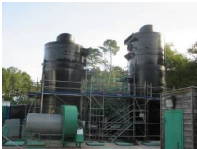
Usine de Gamarde à Saint-Médard-en-Jalles : Tours de stripping mises en place en 2010 suite à la pollution ETBE
