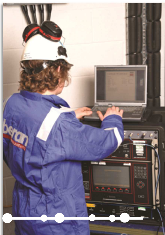
Figure 24 : Mise en place de l'analyseur PlantProtech 766 par Beran à l'UVE de Cenon
