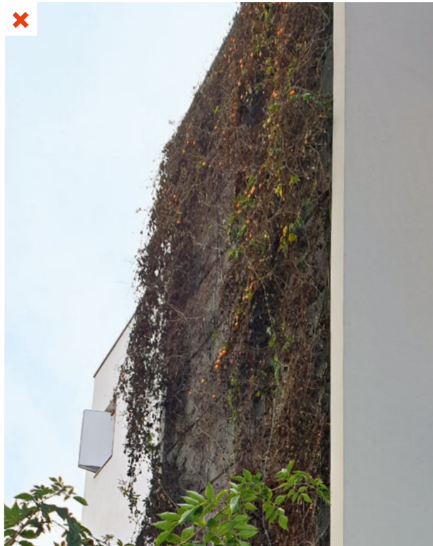
Après 2 années d'existence, la végétation présente sur cette façade s'est asséchée. Les occupants se plaignent de la nuisance visuelle. ©AQC
