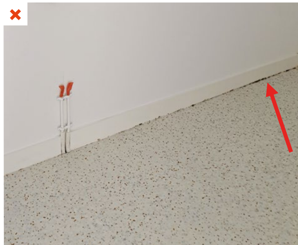
Des moisissures se développent en pied de cloison dans cette salle de bains d'un logement témoin dépourvue d'ouverture et de ventilation (phase chantier). ©AQC
