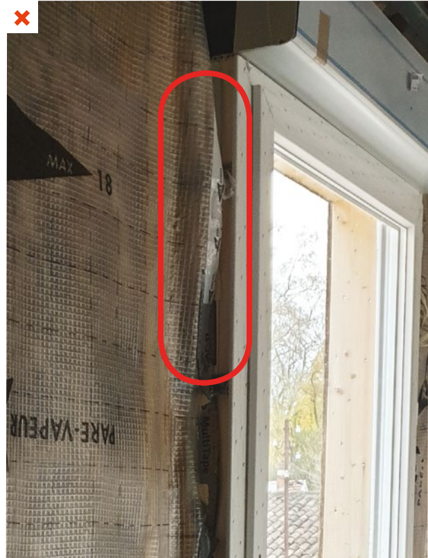
La jonction mur/menuiserie n'est pas assurée entraînant un défaut d'étanchéité à l'air. ©AQC
