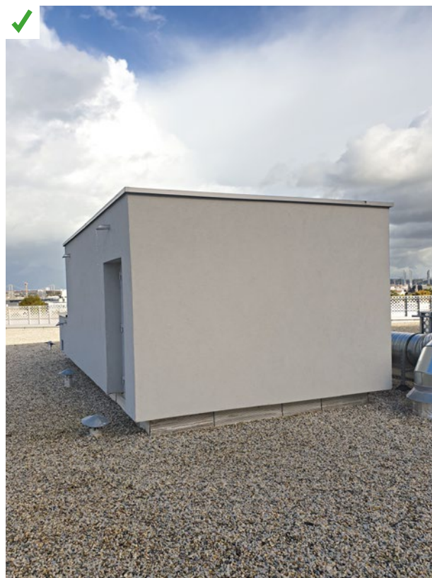
Le local technique sur la toiture-terrasse permet de supprimer les nuisances sonores et l'impact visuel du groupe de CTA pour le voisinage immédiat. ©AQC
