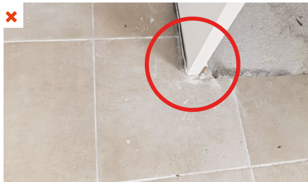
La remontée de la bande de rive est absente. L'isolation acoustique n'est pas assurée au niveau de l'extrémité de la cloison. ©AQC
