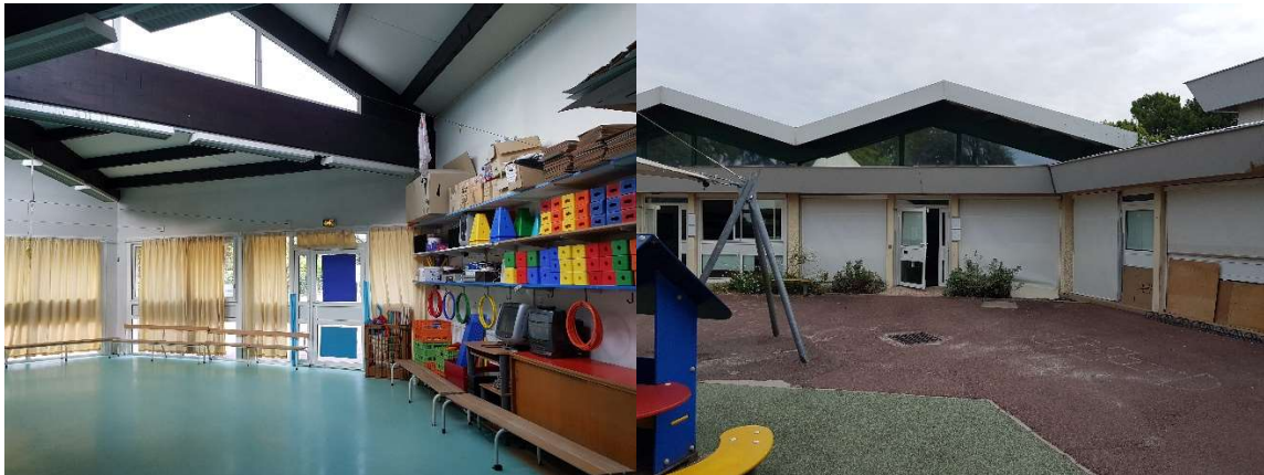
Menuiseries en partie haute en simple vitrage (intérieur : salle de motricité, extérieur : salles de classes)
