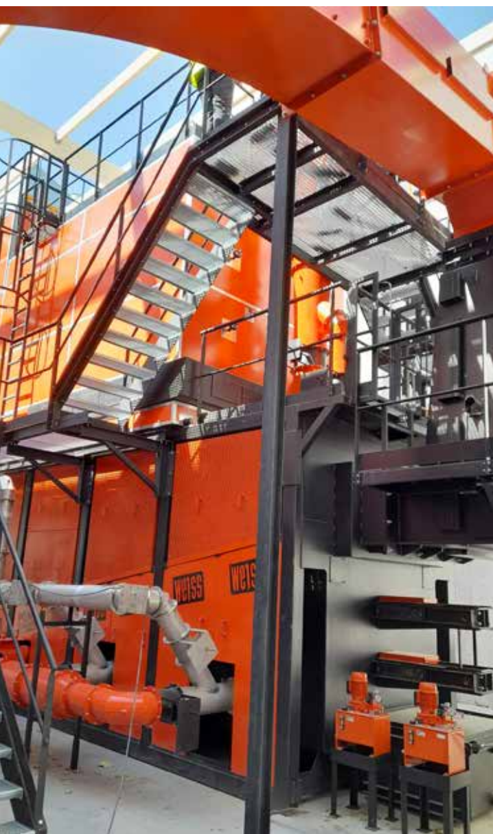
Chaufferie biomasse Plaine de Garonne Energies. Source : Dylan Masclaux - Bordeaux Métropole
