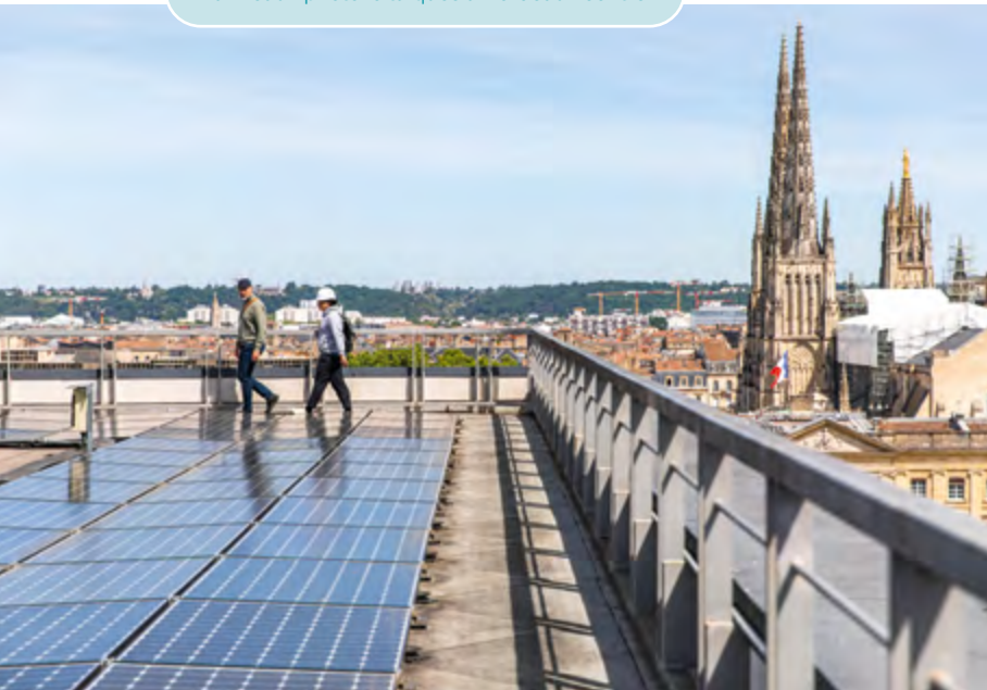
Panneaux photovoltaïques à Bordeaux centre
