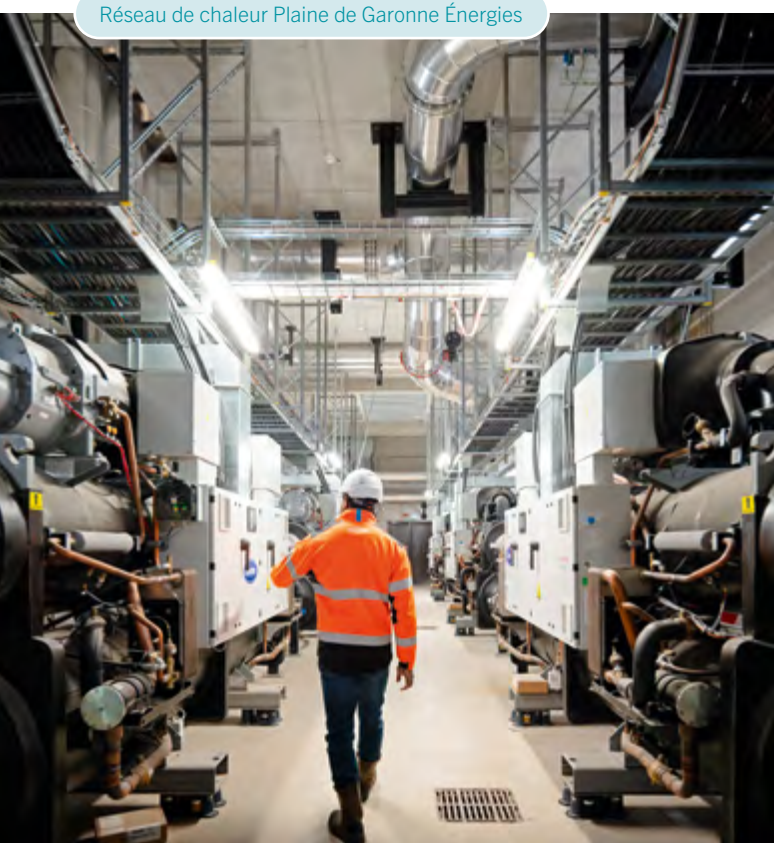
Réseau de chaleur Plaine de Garonne Énergies
